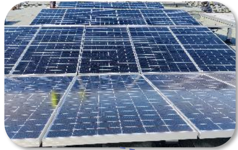
Centrale photovoltaïque en toiture
